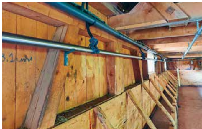
Neu installierte Absauganlage im Gstollen
